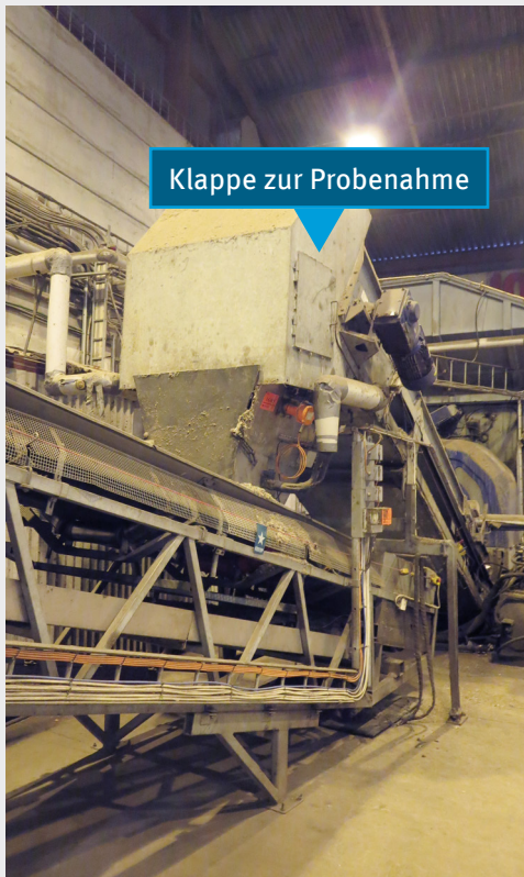
Bandabwurf mit Kennzeichnung der Klappe zur Probenahme
